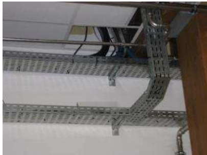
Chemin de câbles de type dalle perforée
