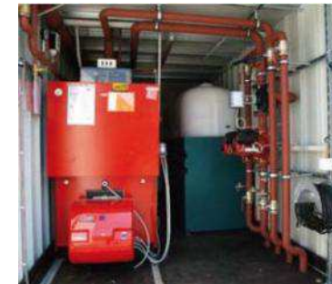
Exemple de chaudière mobile de secours
