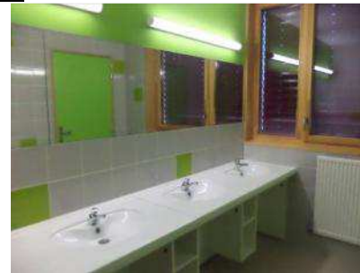
Lavabo incorporé dans plan thermoformé (internat) Robinet type presto à fermeture temporisée
