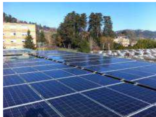
Exemple d'installation photovoltaïque en toiture
