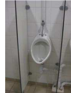
Urinoir de type urinoir « à stalle » avec cloisonnette de séparation
