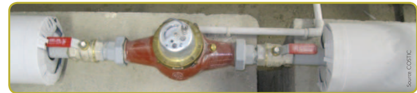
Vannes d'isolement en amont et en aval, compteur placé dans un point bas, à l'horizontale
