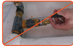
Le doigt de gant n'atteint pas le centre de la canalisation, la sonde ne sera pas immergée dans l'écoulement
