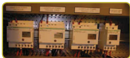
Compteurs électriques sur rails DIN, explicitement libellés
