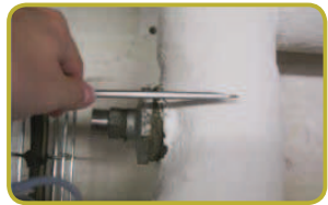
Le doigt de gant atteint le centre de la canalisation, l'élément sensible de la sonde sera bien placé dans l'écoulement
