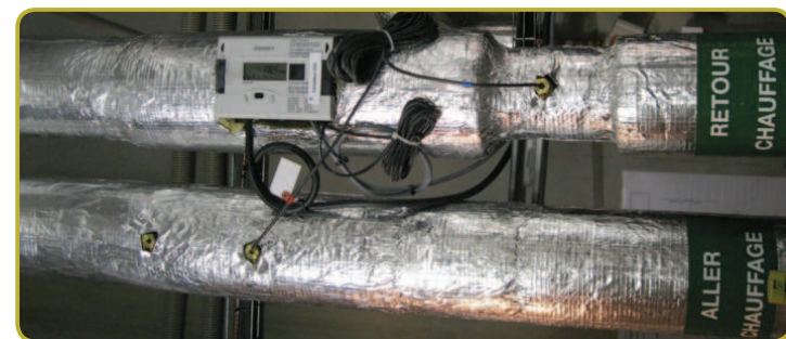
Compteur d'eau sur le retour, longueurs droites suffisantes, doigt de gant doublé pour comparer les sondes de températures
