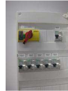
Coffret électrique laboratoire
